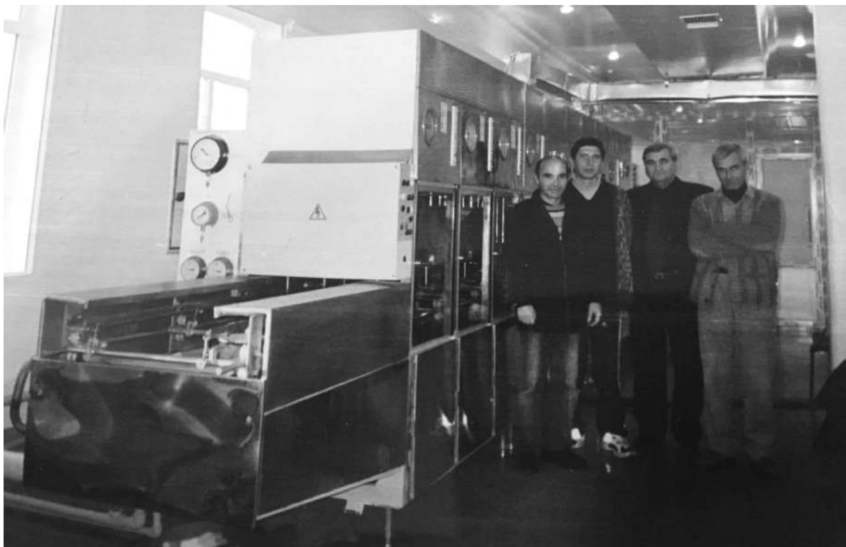
Рис. 8.14 – Батумский фармацевтический завод. Автоматическая линия ампулирования лекарственных средств успешно внедрена
